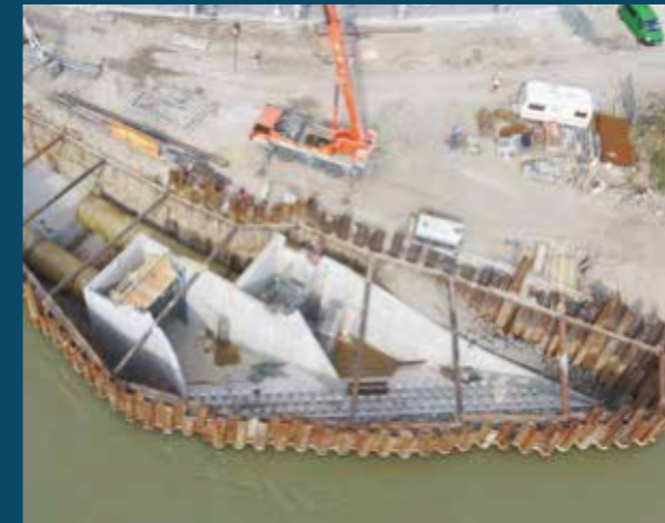
Kvassay szivattyútelep Kvassay pump station
